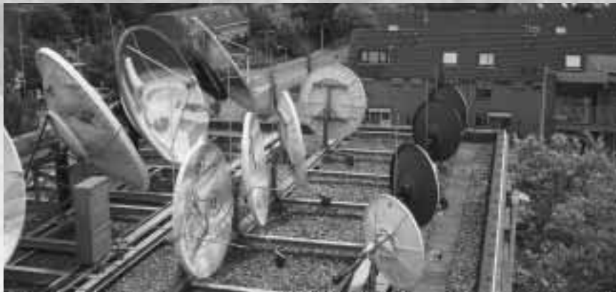
Mediakabel verzorgt voor alle grote kabelexploitanten de ontvangst en distributie van de digitale tv-diensten
